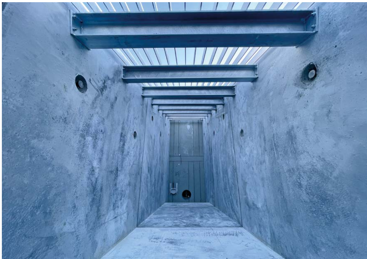
Die Hochwasserentlastung des Rückhaltebeckens erfolgt in zwei Stufen. Nach Erreichen des Vollstaus bei einem 100-jährlichen Hochwasserereignis springt die erste Entlastung am Auslassbauwerk über den rückwärtigen Schacht an.
