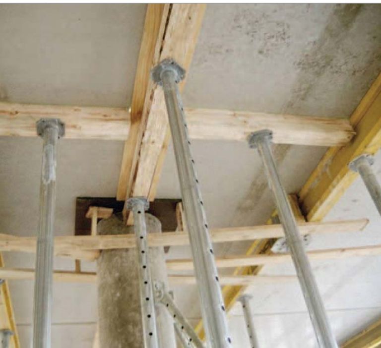
Bild 15: Abschalung von Druckfugen
